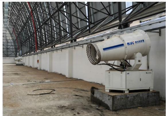
煤棚消防降尘设施
