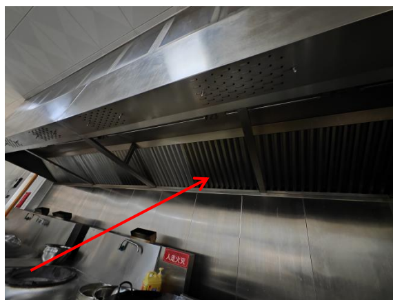
厨房油烟收集系统
