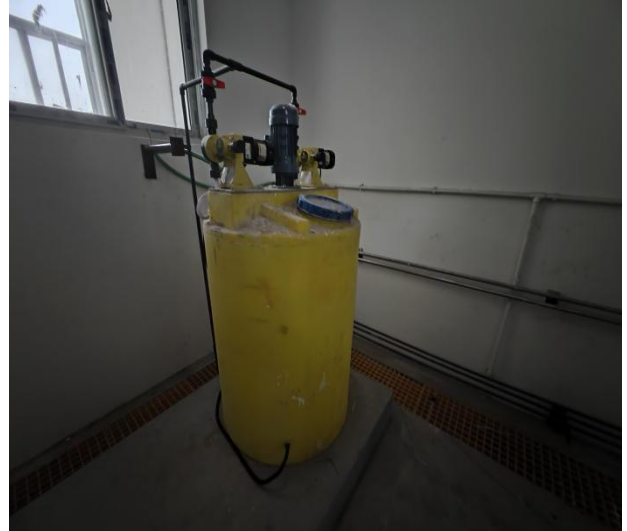
污水站二氧化氯（消毒剂）加药装置
