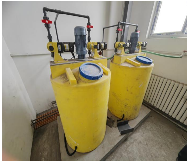
污水站 PAC、PAM（混凝剂）加药装置
